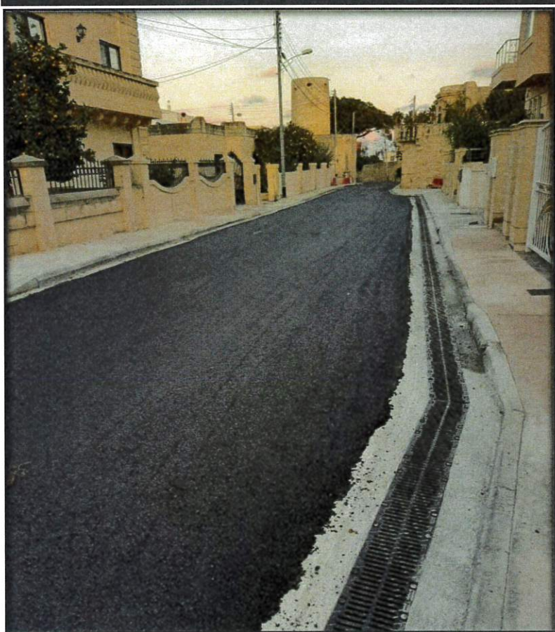
Wiċċ ġdid fi parti minn Triq A. Preca, bl-għajnuna ta' Infrastructure Malta
